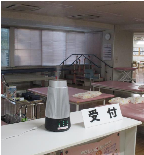
①低オゾン水素発生器 設置 写真（1階 リハビリセンター）
